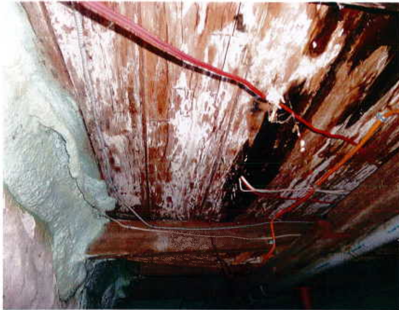
Photo no.5 : Les planches de bois sous le plancher du rez-de-chaussée, dans le vide sanitaire, sont recouvertes de champignons et de pourriture causés par l'humidité.
