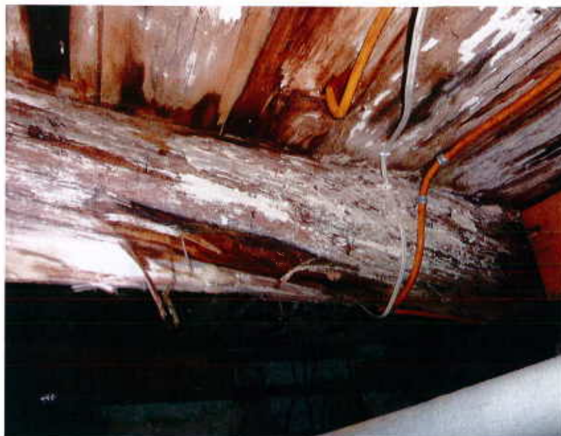
Photo no.7 : Les poutres et les planches de bois dans le vide sanitaire sont atteintes par l'humidité. La surface des poutres présente des traces de moisissure importantes.
