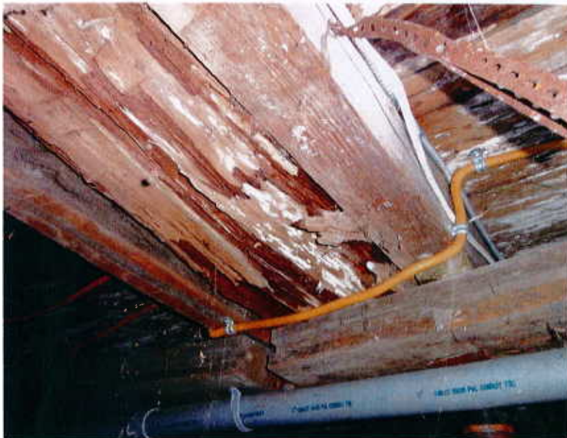
Photo no.6 : Les poutres dans le vide sanitaire sont atteintes par l'humidité. La surface des poutres présente des traces de moisissure importantes.
