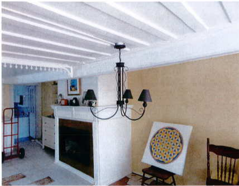
Photo no.11 : Poutre supportant le plancher du 2 e niveau courbé sous la charge.
