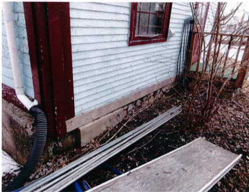
Photo no.3 : Fondation en moellon du bâtiment vue de l'extérieur. Les pierres se détachent et le mortier s'effrite. Certaines sections des fondations de pierre ont été recouvertes d'un mur de fondation en béton.
