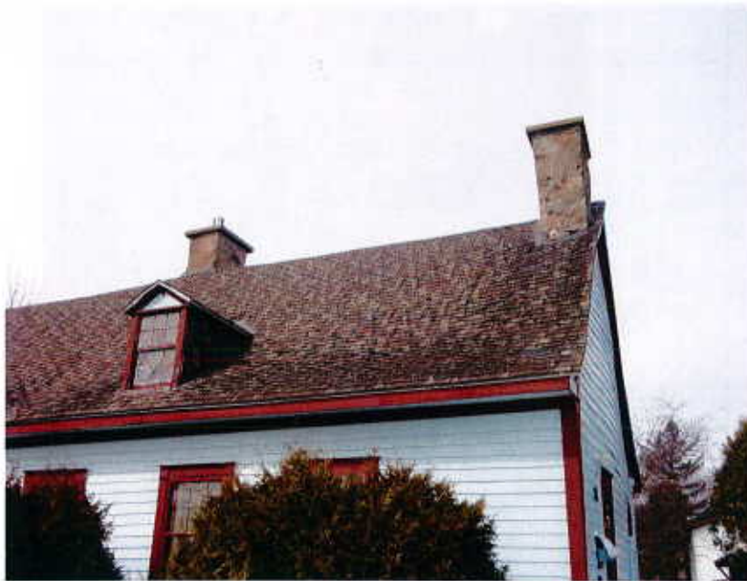
Photo no.9 : Dégradation de la toiture et bombement dans le mur extérieur
