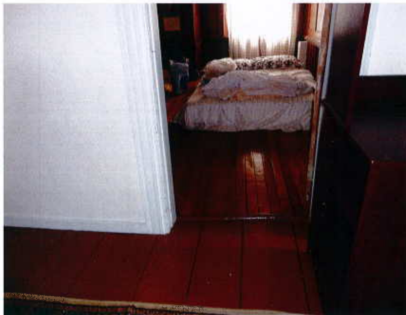
Photo no.12 : Pente existante d'environ 6 pouces dans le plancher.
