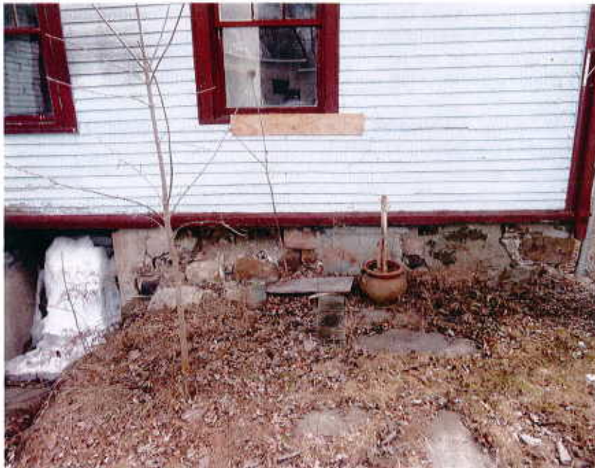
Photo no.2 : Fondation en moellon du bâtiment vue de l'extérieur. Les pierres se détachent et le mortier s'effrite.
