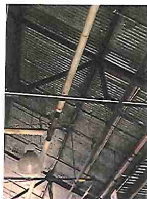
Photo 2 : Isolant de conduites
